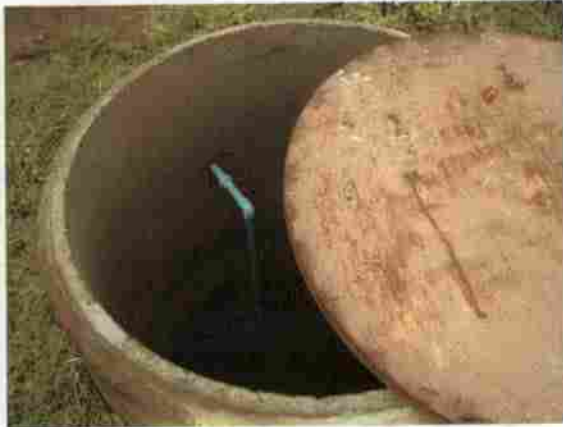
Cámara de captación agua potable
