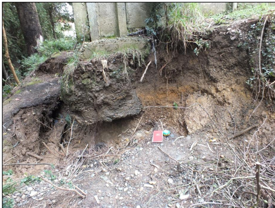
Figura 8. Imagen del desplazamiento vertical del relleno (1,2 m) que afecto parte de las instalaciones de la Escuela Rayen Lafquén en el punto A (patio).
