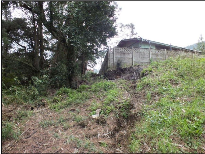
Figura 7. Vista general de la corona del deslizamiento (punto A) que afecto parte de las instalaciones de la Escuela Rayen Lafquén (patio).
