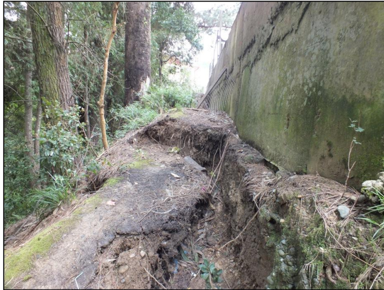
Figura 9. Imagen del desplazamiento horizontal del relleno (80 cm en total) que afecto parte de las instalaciones de la Escuela Rayen Lafquén en el punto A (patio).
