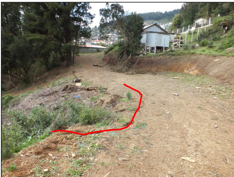
Figura 12. Imagen de grieta de tensión (línea roja) paralela al borde de plataforma de relleno artificial al oeste de la Escuela Rayen Lafquén (punto C).
