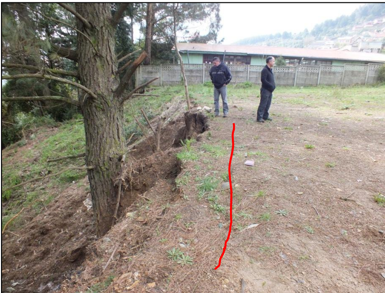
Figura 10. Imagen de grieta de tensión (línea roja) paralela al borde de plataforma de relleno artificial justo al oeste de la Escuela Rayen Lafquén (punto B). Nótese el pino inclinado.
